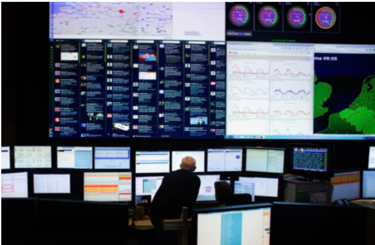
Het Network Operations Center van KPN in Hilversum. Het moet alle netwerken van het bedrijf, bewaken, zoals tv, telefoon en internet.
